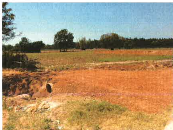
รายงานโครงการขุดวางท่อระบายน้ำ บ้านหนองบัวบาน หมู่ที่9
